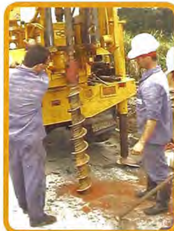
Perfuração com equipamento mecanizado de soldagem com emprego do trado vazado estanque (hollow stem auger)
